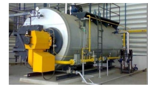
Bồn công nghiệp Industrial tank
